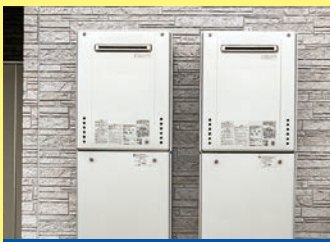
給湯器・ポンプの故障 温度調節ができない
